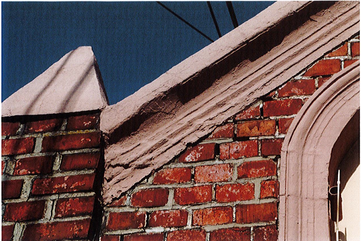
Fot.5. Zniszczenia dekoracyjnych profili. Pęknięcia wtórnej fugi. Zanieczyszczenie cegły
