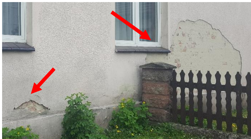
Fot. 3 Skorodowane tynki elewacji
