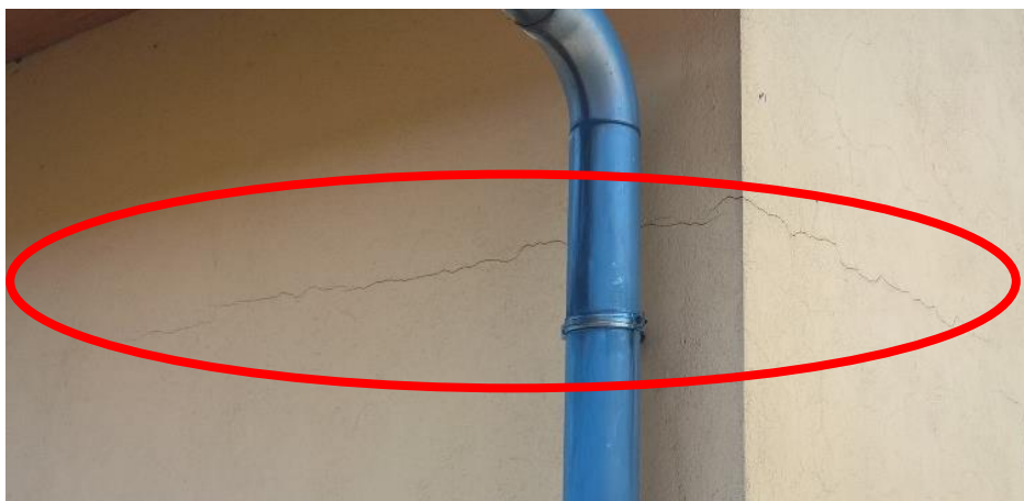
Fot. 4 Zarysowanie ścian na wysokości łączenia z stropem
