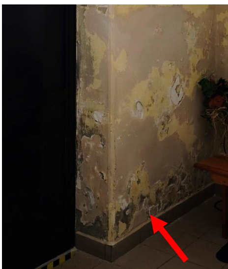
Fot. 5 Zawilgocona ściana wewnątrz budynku
