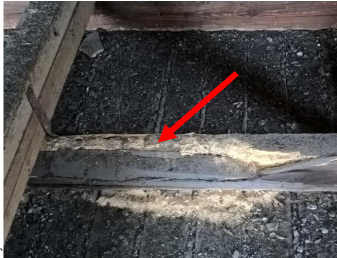
Fot. 2 Spróchniała belka drewniana więźby
